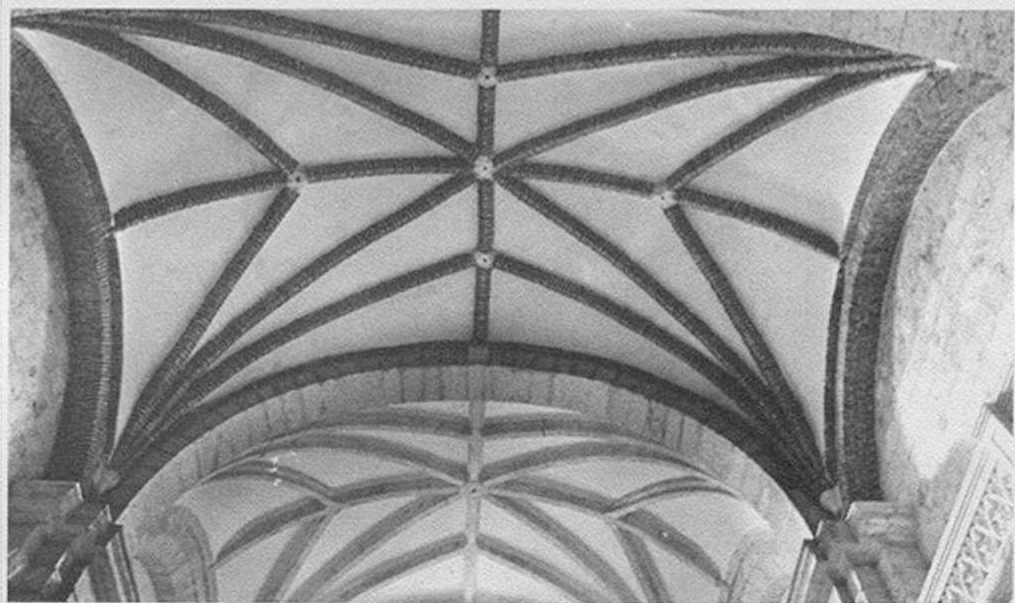
Detalle de una sección de la bóveda con nervaduras de ladrillo. Al fondo, un trabajo similar en piedra.
